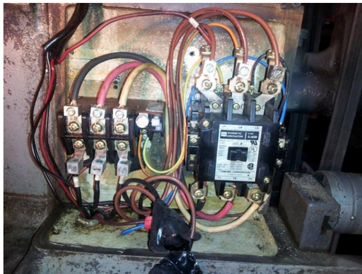
Hình 1.52 Công tắc tơ và Rơ le nhiệt trên tủ điều khiển của một máy công cụ
