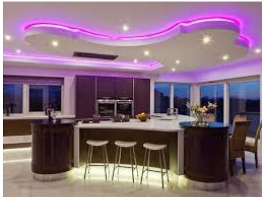
Hình 4.1. Hình hệ thống chiếu sáng
