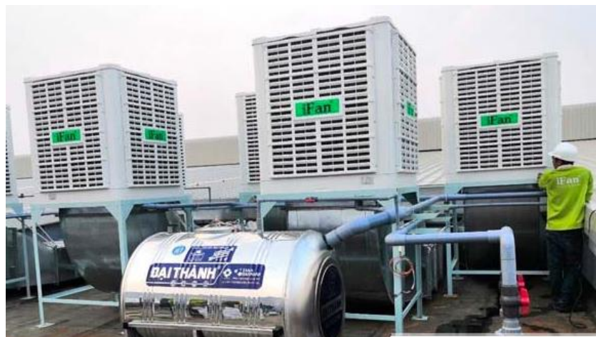
Hình 4.6. Kiểm tra hệ thống thông gió
