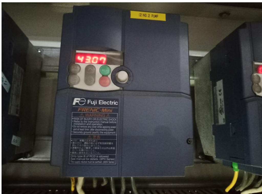
Hình 7: Biến tần Fuji điều chỉnh tốc độ quạt trong hệ HVAC tại AEON Tân Phú.
